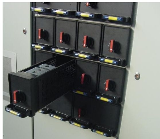
Fot. 2 Szafa rozdzielnic RNW z modułami w wykonaniu wysuwonym.
