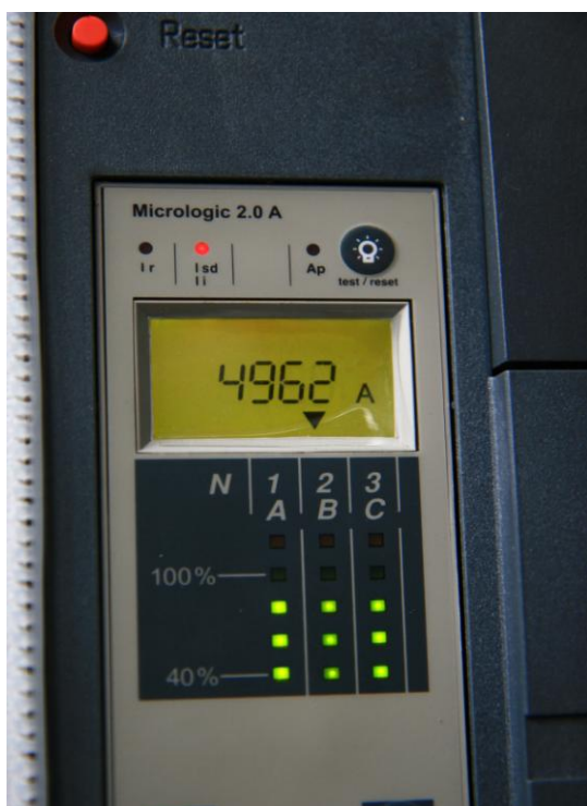
Fot.1 Moduł zabezpieczeniowy wyłącznika Masterpact w polu zasilającym.
