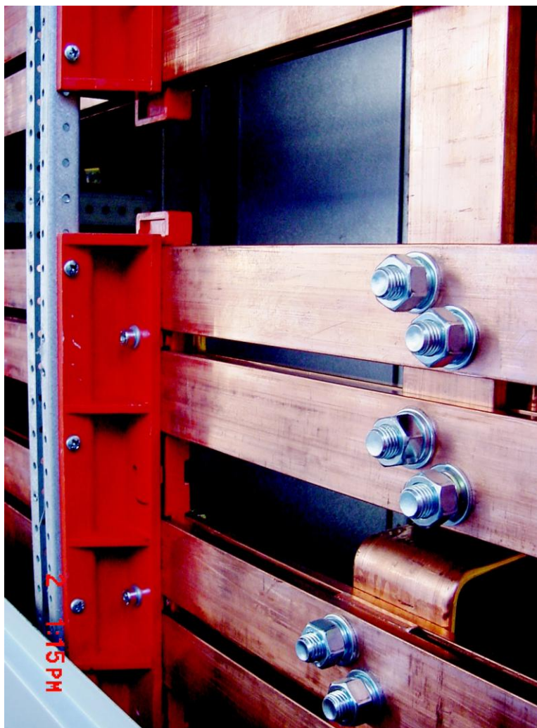
Fot. 3 Fragment głównego toru szynowego rozdzielnicy RNW
